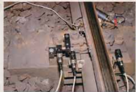
Mit Fühler 5 wird die Kippkraft am Schienenkopf gemessen
